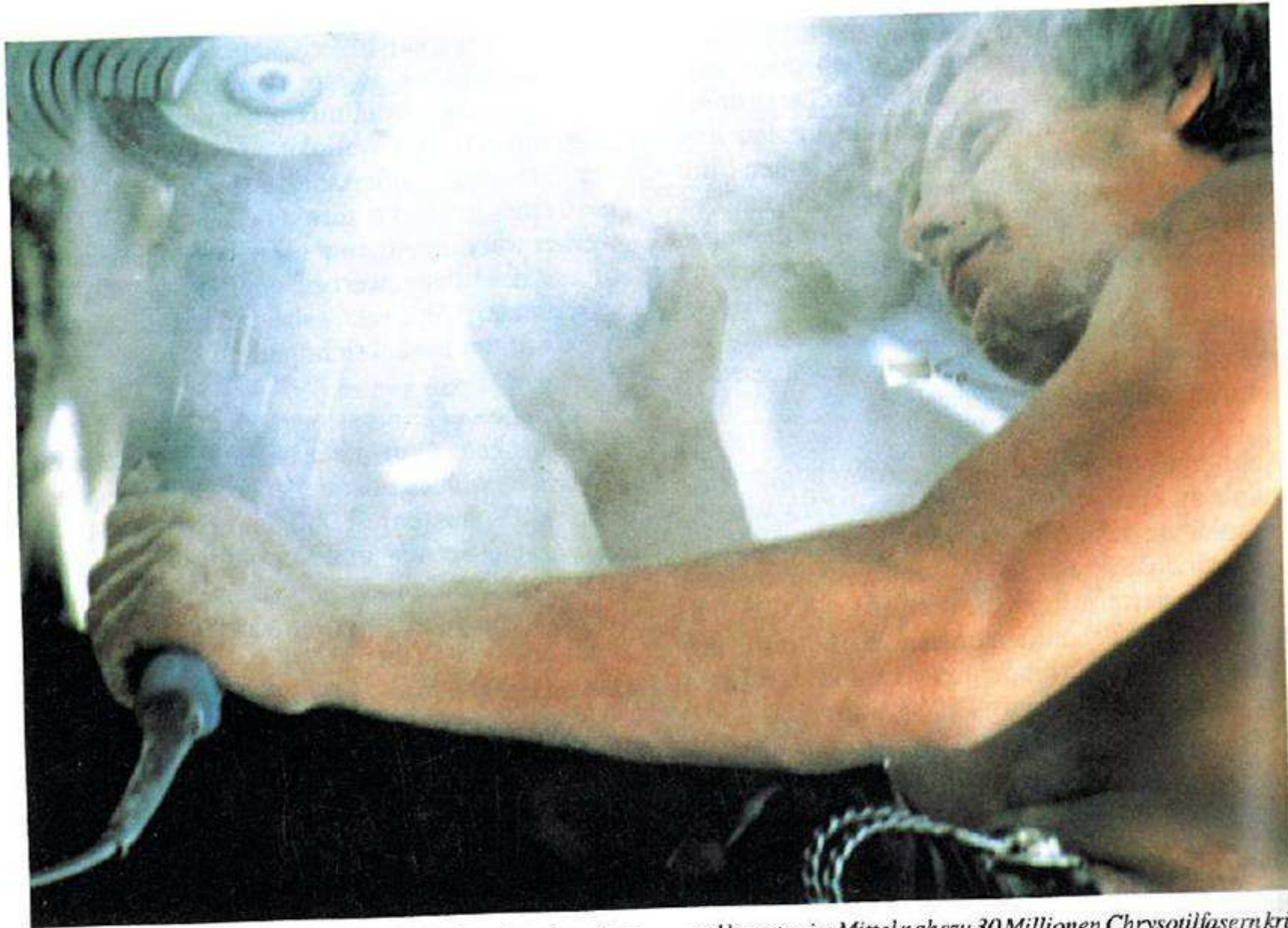
Abb. 15: Anwenderproblematik: Arbeitsplatzsituation eines jungen Dachdeckergerellen mit kurzzeitig extrem hoher direkter Einwirkung von Asbestzement-Faserstaub bei der Bearbeitung von großformatigen Asbestzementwellplatten mittels Trennschleifer (Flex). Bei derartigen Kantenschnitten am Sta-
