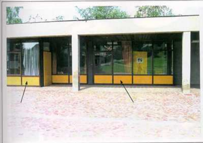
Foto 3: Volksschule, Milland: Fassadenplatten - Asbestzement
