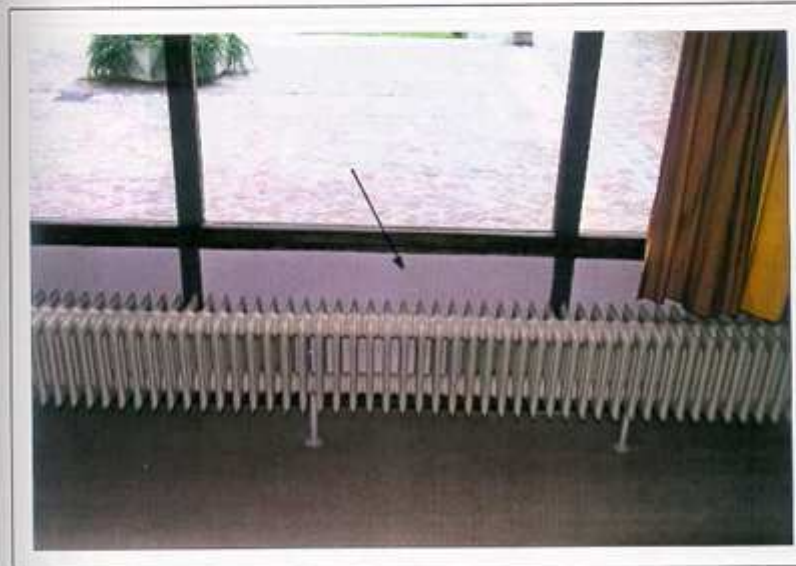
Foto 4: Volksschule, Milland: Fensterbrüstungsplatten - Asbestzement
